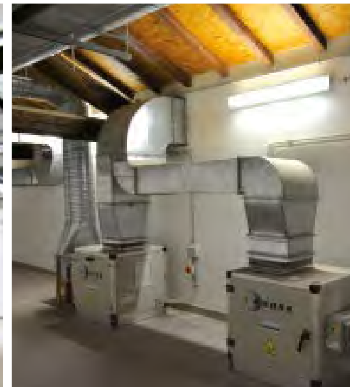
Piano sottotetto canalizzazioni impianto
