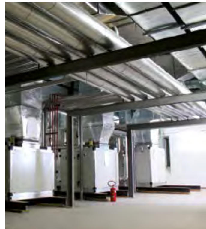
Centrale di condizionamento Torre Nord
