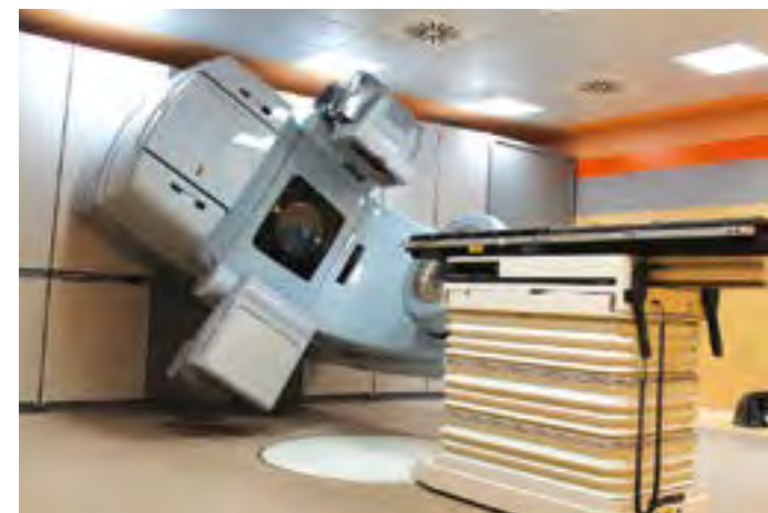
Acceleratore lineare Bunker Sud
